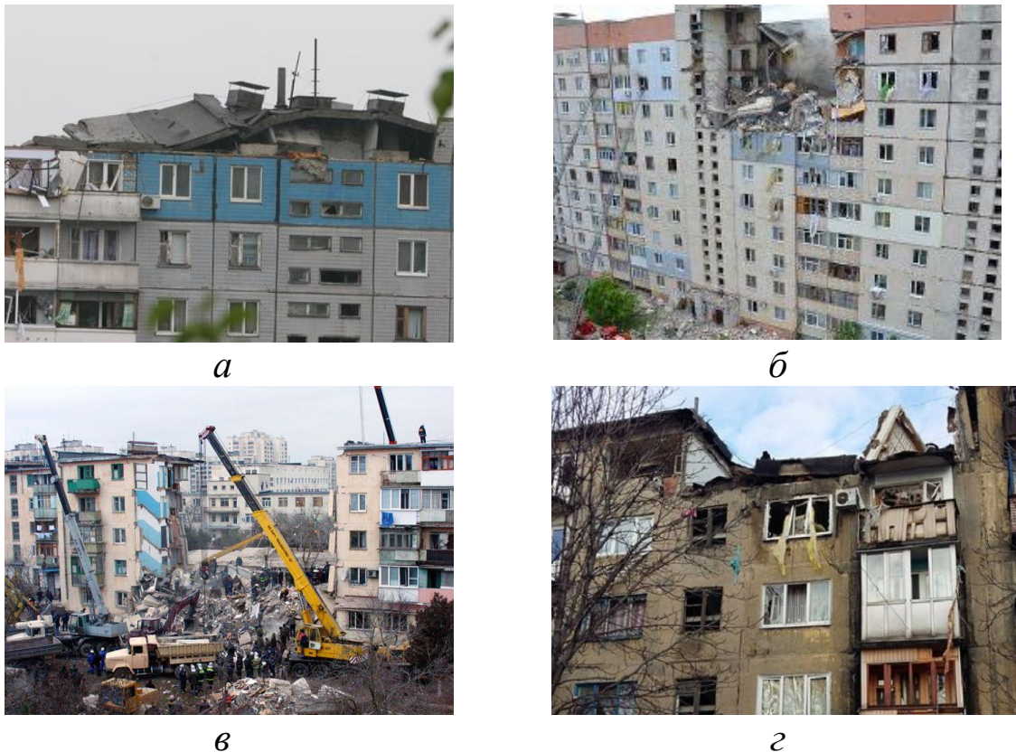
Рис. 2. Пошкоджені вибухами газу житлові будівлі: а – м. Дніпро (2007 р.); б – м. Миколаїв (2014 г.); в – м. Євпаторія (2008 р.); г – м. Українськ (Донецької обл., 2016 р.)
