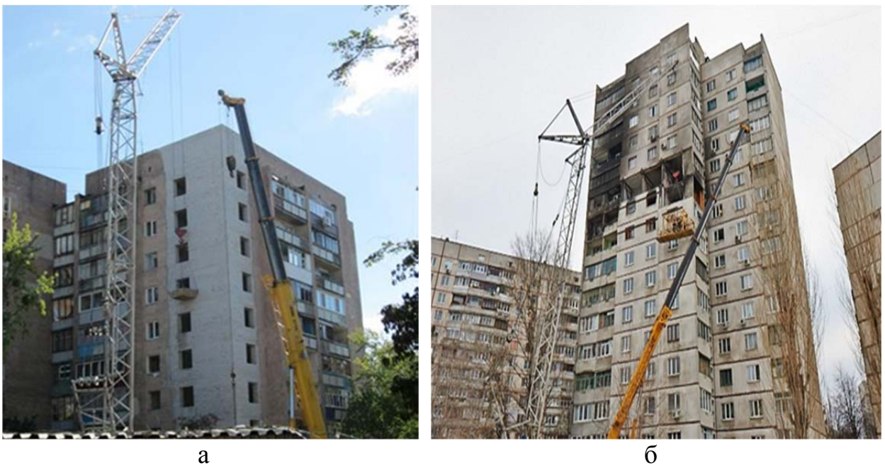
Рис. 1.14. Восстановление поврежденных домов в г. Харьков (2012 г.): а) - по ул. Слинько; б) – по пр. Московский
