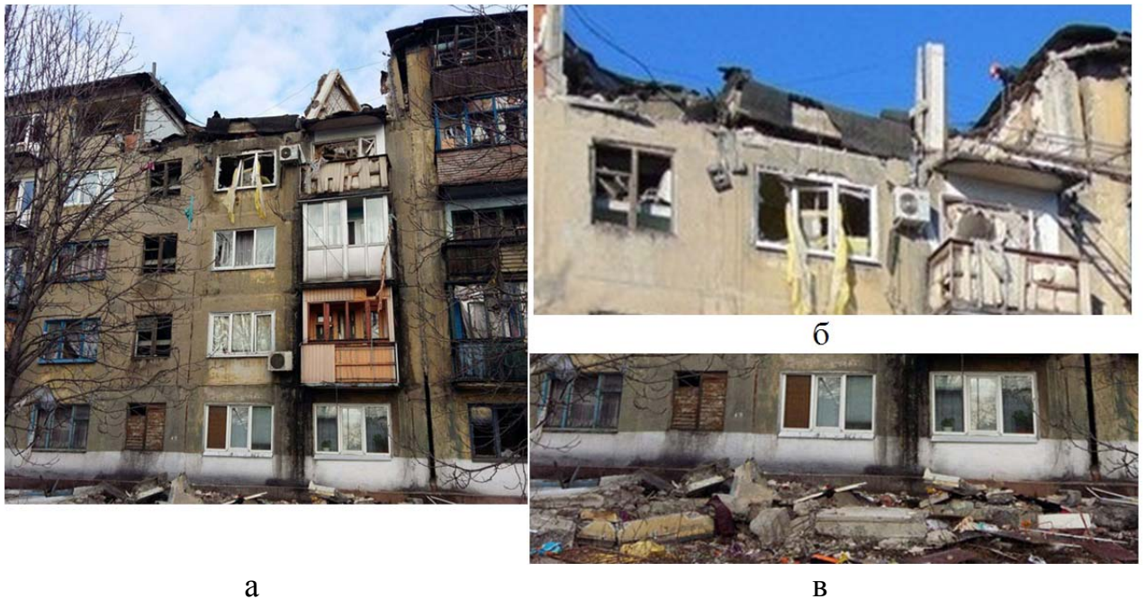
Рис. 3.7. Разрушения от взрыва газа в жилом доме в г. Украинск (2016 г.): а – секция дома; б – разрушенная крыша и 5-й этаж; в – обломки
