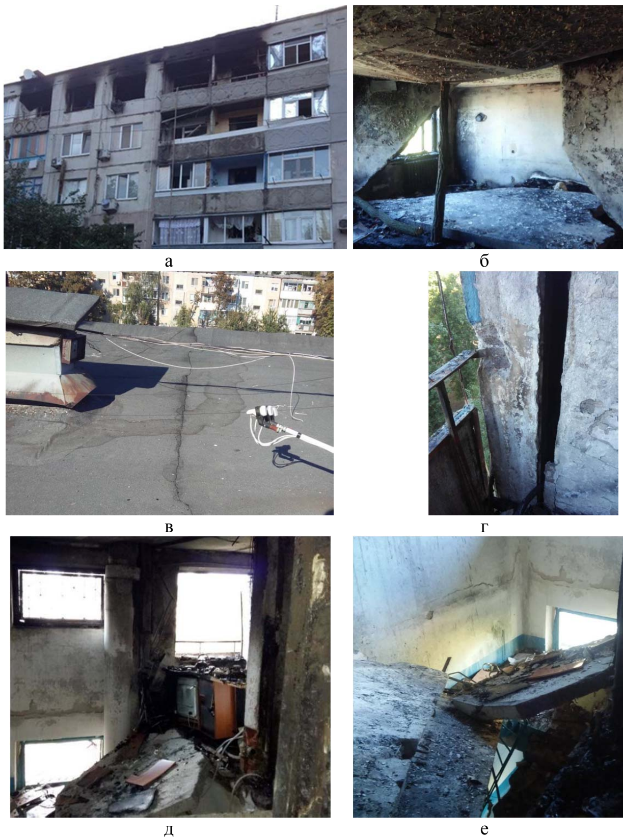
Рис. 3.5. Последствия взрыва в 5 - этажном доме в г. Павлоград (2016 г.): а – вторая секция; б – разрушенное перекрытие 5-го этажа; в – трещина в крыше; г – смещение стеновой панели; д, е – разрушение стеновых панелей
