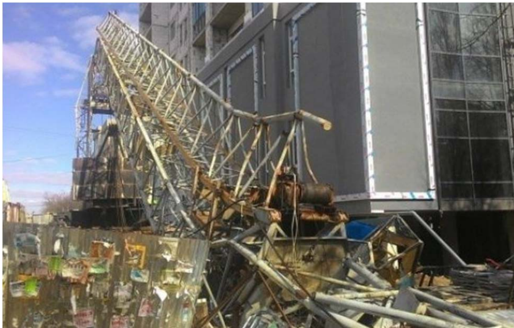
Рис. 1.20. Обрушение конструкции строительного крана в г. Ровно
