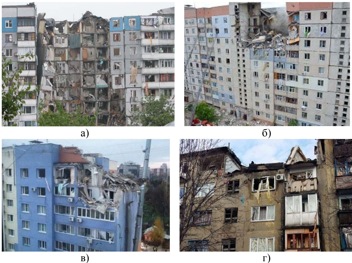
Рис. 1.2. Поврежденные взрывами газа жилые дома:
