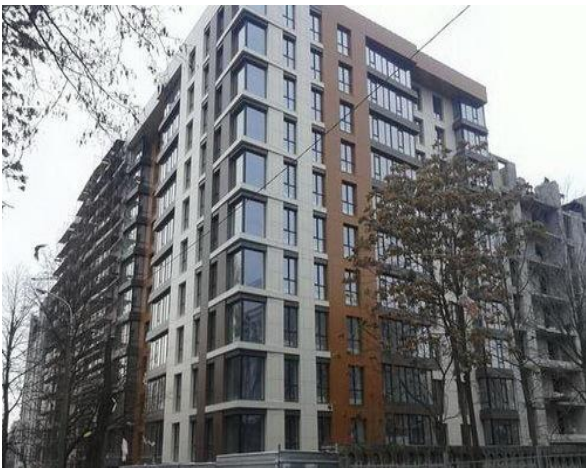
Рисунок 8.2.78 – Житловий комплекс «Жуковський» на перетині вул. В. Жуковського і вул. П. Гусенко (у процесі будівництва)
