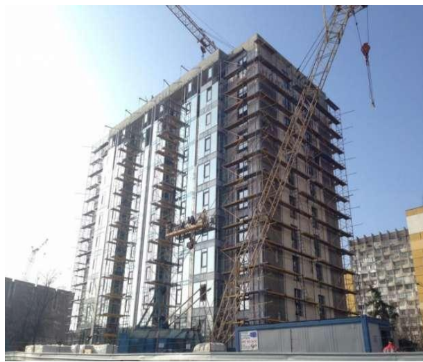
Рисунок 8.2.81 – Житловий комплекс «Салют» за адресою бул. Слави, 2 на ж / м Перемога-5 (у процесі будівництва)
