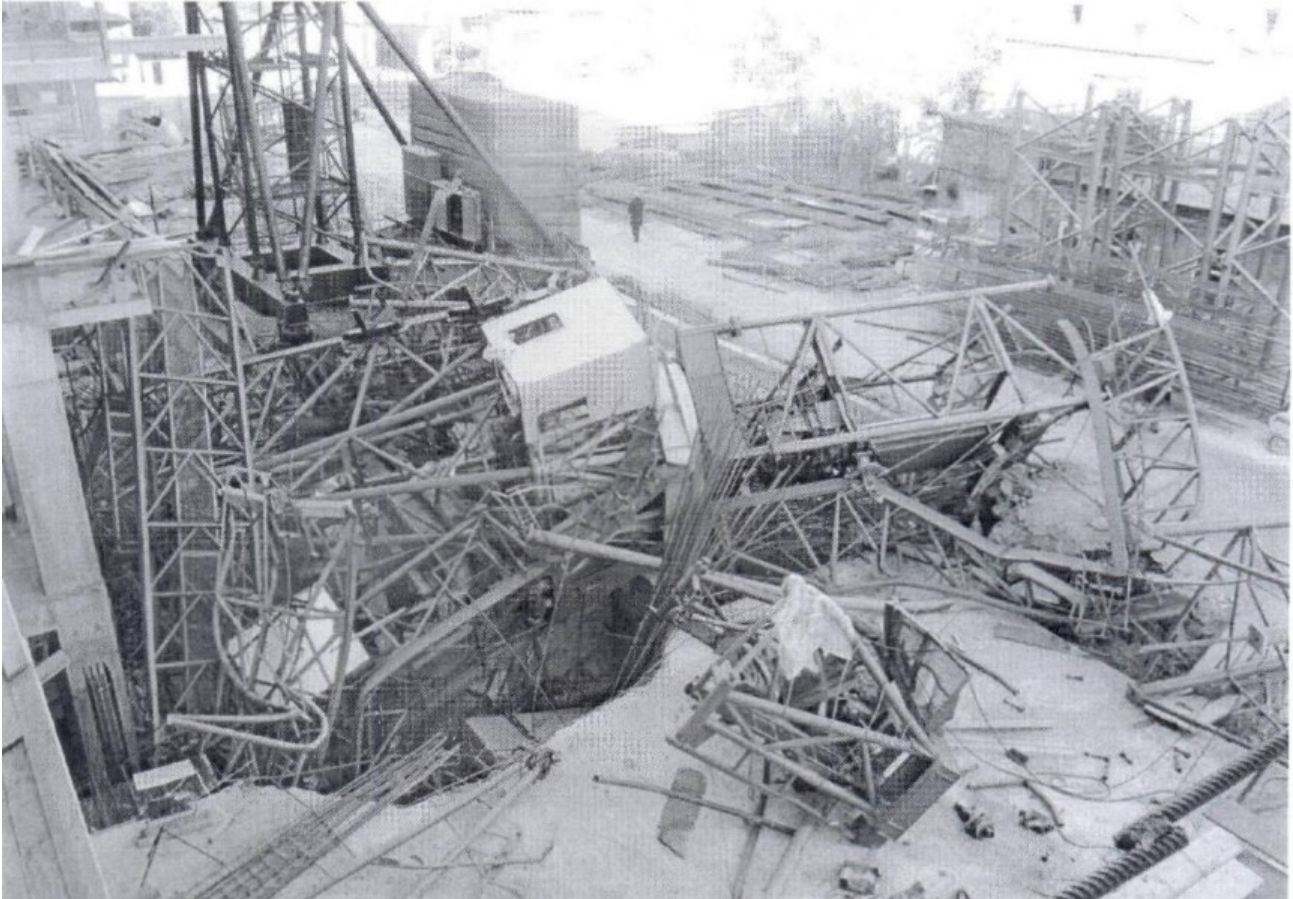
Рис. 1. Загальний вид місця аварії.
