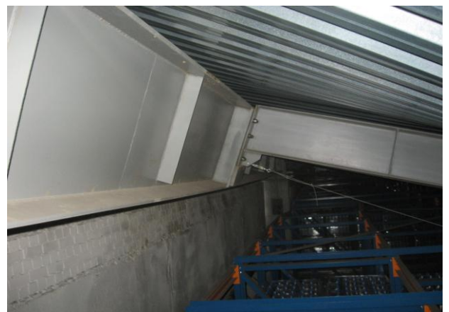
Рис. 4. Отклонение от вертикали колонн крайнего ряда / The deviation from the vertical columns of the last row
