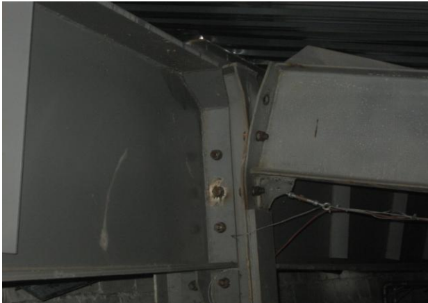
Рис. 6. Состояние узла крепления балок крайнего ряда к подстропильной балке / The state of the attachment of the beams of the outermost row to the sub-rafter beam
