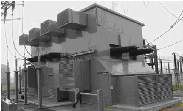
Рис. 1 – Силовий трансформатор із звукоізоляційним блоком / Power transformer with sound insulation unit
