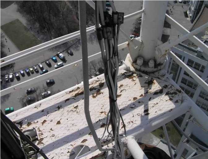
Фото 3. Состояние металлоконструкций башни на отм. 85.50 м /
