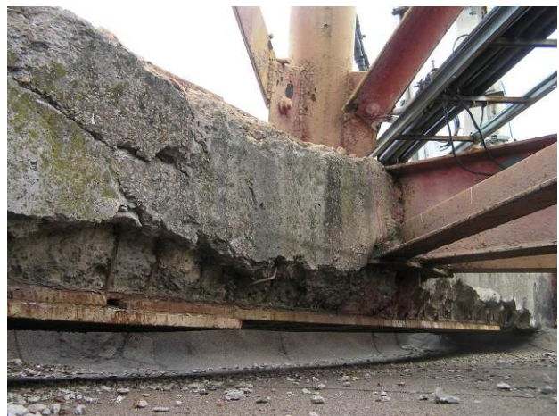
Фото 5. Разрушение обетонировки металлических балок рамы на глубину до 100мм, оголение и коррозия хомутов до 100% /
