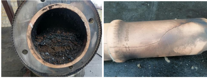
Рис. 1. Стан димоходу твердопаливного котла на об'єкті (ліворуч – засмічення продуктами згоряння, праворуч – тріщини)
