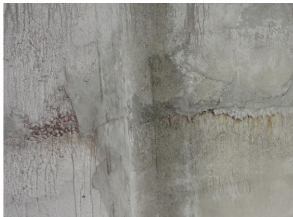
Рис. 6. Непробетоновані місця у конструкціях та «холодні» шви бетонування
