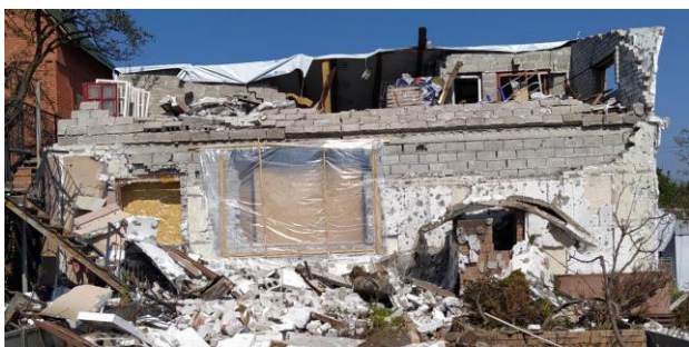
Рис. 1. Суттєво пошкоджений внаслідок ракетного обстрілу приватний будинок в м. Дніпро
