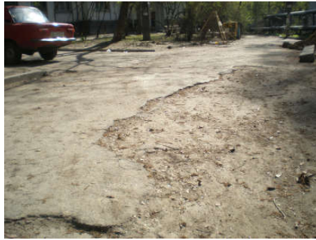
Рисунок 3.2 Дорожнє покриття у поганому стані
