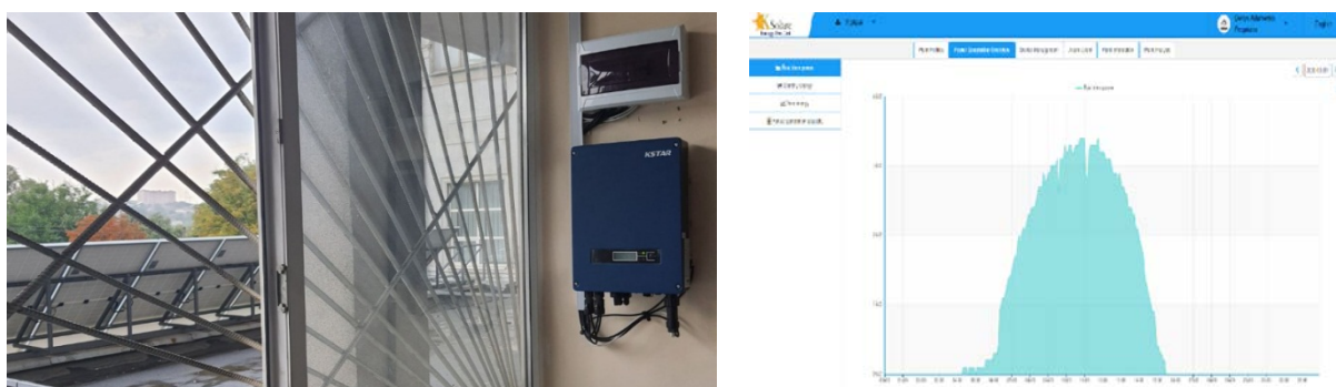
Рис. 6.2. Інвертор 5 кВт та моніторинг роботи СЕС
