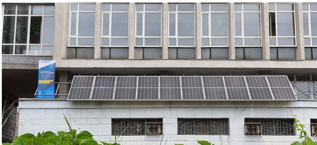
Рис. 6.1. Загальний вигляд сонячної електростанції Енерго-інноваційного Хабу ПДАБА
