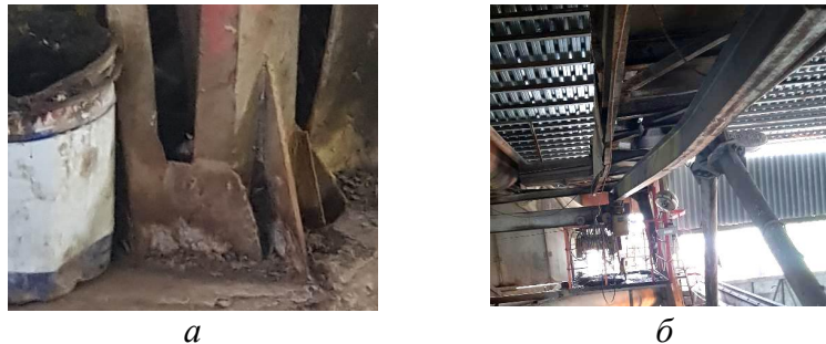
Рис. 2. Виявлені дефекти споруди надшахтного копра ствола «РЕ-6»: а – корозія фасонки бази колони; б – вигин балки монорельсу
