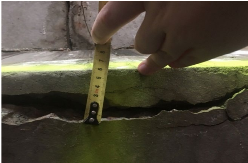
Рис. 4. Горизонтальні тріщини шириною розкриття a_T = 30 мм в розтягнутій зоні ригеля по нижній поверхні, корозія поздовжньої робочої арматури на позн. +11,200 (4-й поверх), по осі «1» в осях «Д–Е»
