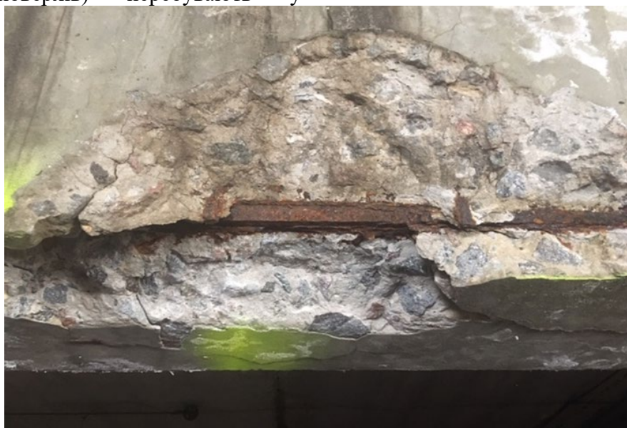
Рис. 2. Замокання ригелів на позн. +11,200 (4 поверх), по осі «1» в осях «Д-Е», корозія робочої арматури, відшарування захисного шару бетону. Збірні залізобетонні ригелі 4-го поверху в осях «Д-Е» по осях «3», «4», «5», «11», «13», в осях «Б-В» по осях «14», «19», «20-24» перебувають у технічному стані, непридатному до нормальної експлуатації (3-тя категорія), непридатні до подальшої експлуатації та потребують антикорозійного захисту арматури, відновлення захисного шару бетону та підсилення ригелів залежно від результатів розрахунку (рис. 3)
