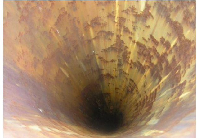
Рис. 2. Корозійний знос з середини труби факельної установки понад 10 % перерізу
