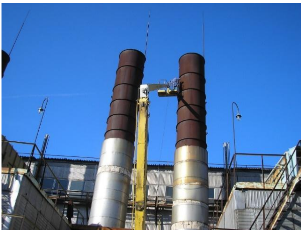
Рис. 1. Металеві димові труби КС «Південнобузька» магістрального газопроводу. Корозійний знос стовбурів труб до 5 %
