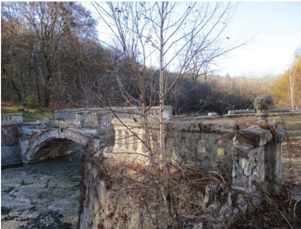
Рис. 6. Балюстрада нижньої тераси зруйнована / Fig. 6. The balustrade of the lower terrace is destroyed
