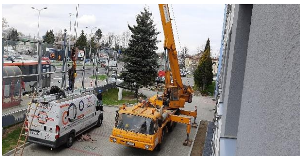
Рис. Встановлення на даху багатопверхівки сонячних батарей для обігріву та подання гарячої води мешканцям, м. Жешув, Польща
