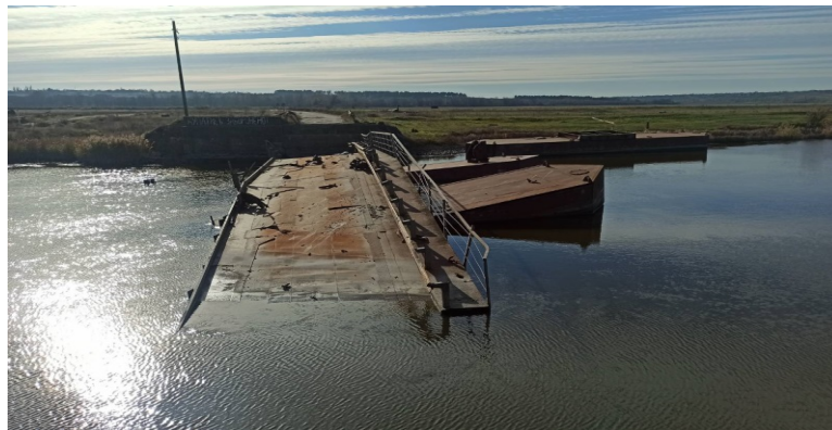
Рис. 1. Міст зруйновано під час окупації н. п. Снігурівка військами рф
